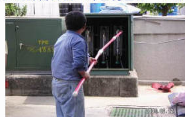
7. 接上電力公司高壓電源開關
