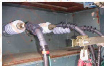
5. 設備輸出接入高壓變壓器一次側
